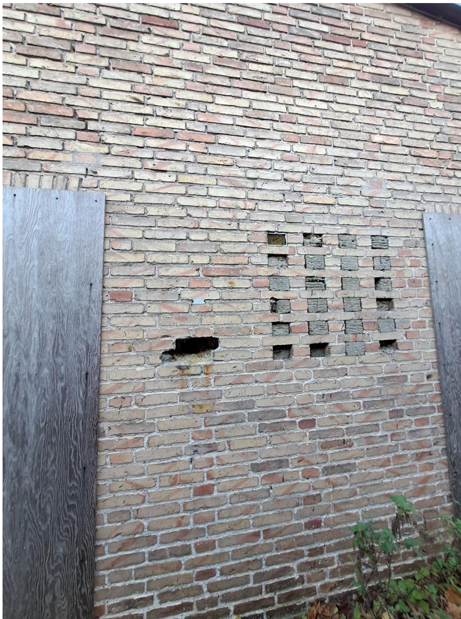
Figur 8. Manglende mursten i facade på bygning på matrikel 12q. ©DMR A/S.
