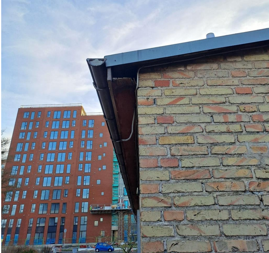
Figur 9. Hulhed ved tag på bygning på matrikel 12q, der potentielt kan udgøre dagsrast for flagermus i sommerhalvåret. ©DMR A/S.
