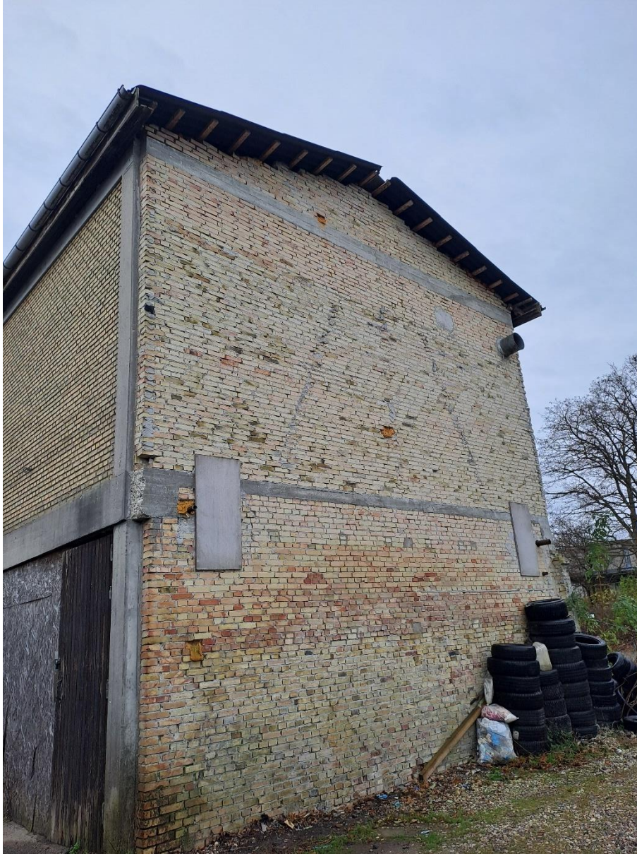
Figur 23. Bygning 3. matrikel 2bk med manglende mursten og sprækker i murværk. ©DMR A/S.
