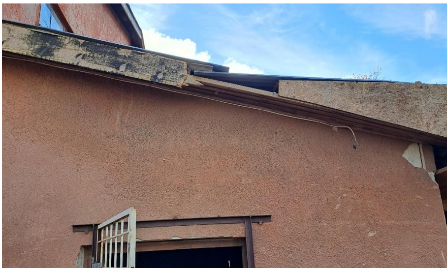
Figur 11. Manglende træplade bygning på matrikel 2bo. ©DMR A/S.
