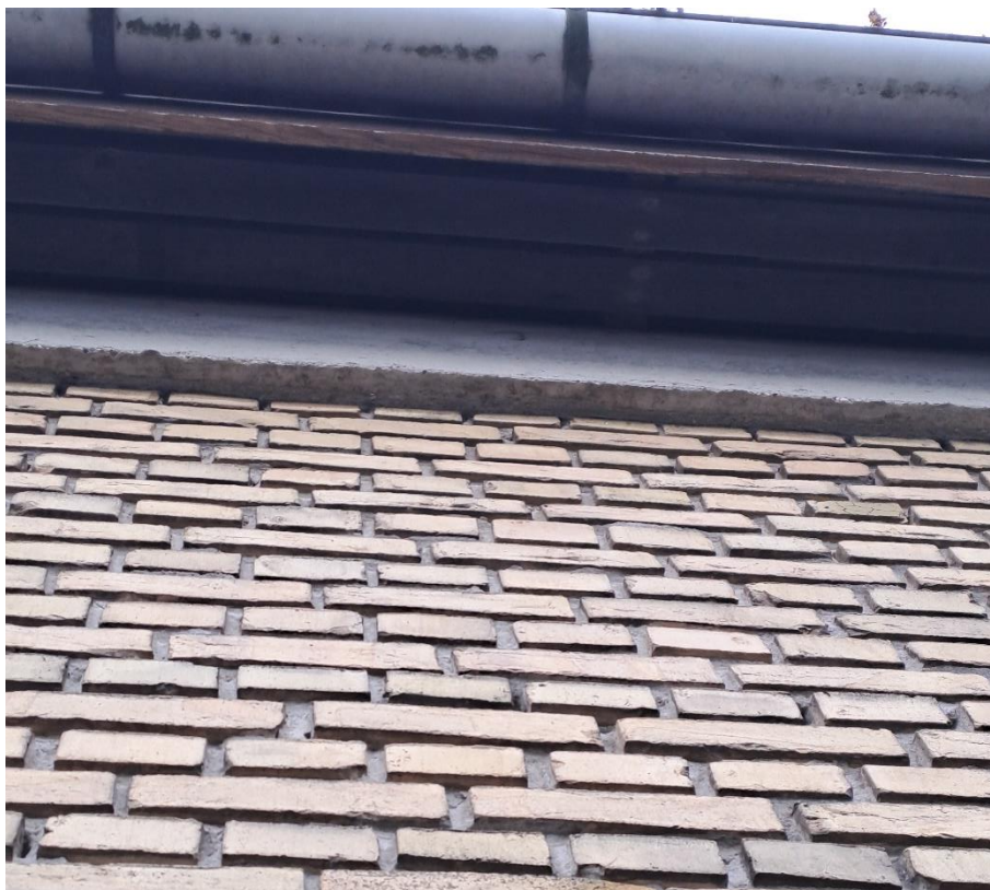
Figur 24. Bygning 3. matrikel 2bk med sprækker mellem planker. ©DMR A/S.
