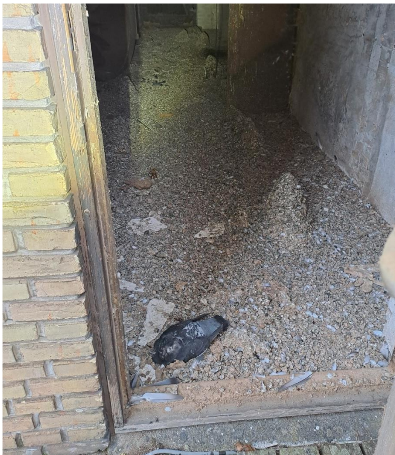
Figur 33. Nylig død tamdue ( Columba livia f. domestica ) og gulv belagt med due afføring. Nordlig del af 1. sal bygning 3. matrikel 2bk. ©DMR A/S.
