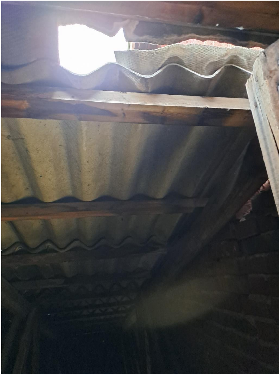
Figur 13. Uisoleret ydertag med hul på bygning på matrikel 2bo. ©DMR A/S.
